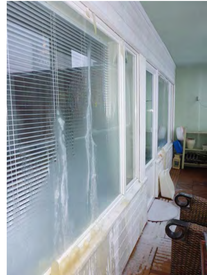
Kuva 5. Rakenteiden epäjatkuvuuskohtien kautta vuotovesiä on päässyt kulkeutumaan laajalti rakenteisiin ja vahinkoaluetta ympäröiviin huoneistoihin. (Kuva: Mikko Koskivuori, AFRY Finland Oy.)
